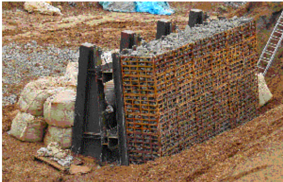
図-5 落石防護壁とダクティルパネル枠
