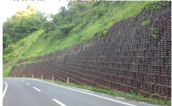
L=60m H=7.5m W=1.0m 450㎡ ・背面からの湧き水を流すことができる ・コンクリートで施工が困難
