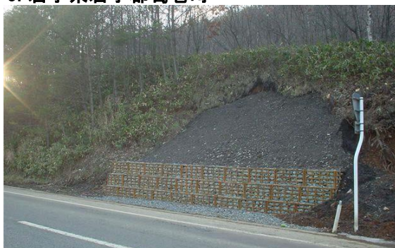
L=10m H=1.5m 15㎡ ・崩壊土砂の流出防止
